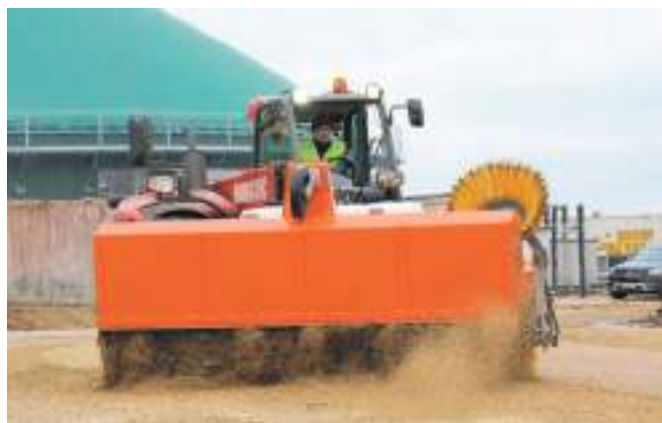
Frifeiing på biogassanlegg med bema 75 Dual PowerMaster
